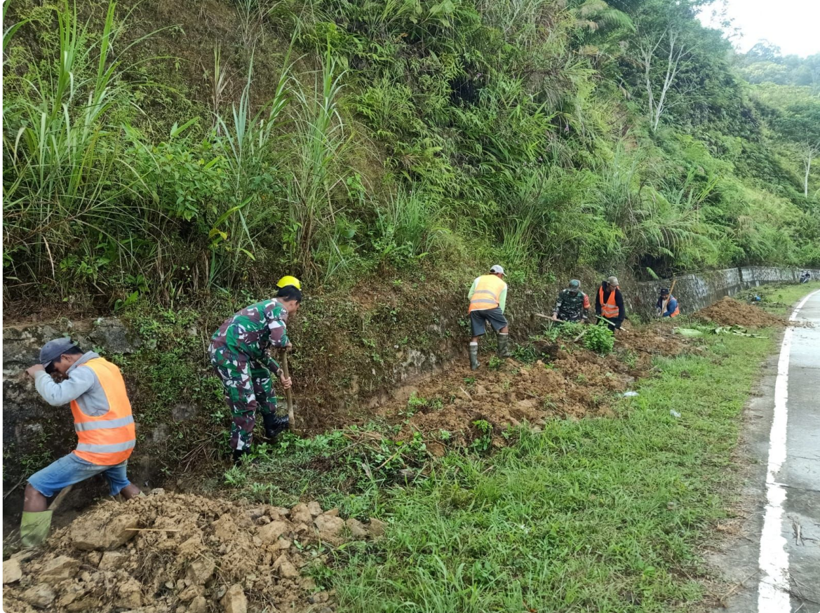
Babinsa Serda Ahmad bersama warga setempat bahu membahu membersihkan saluran air yang tersumbat oleh tumpukan tanah akibat longsor.
